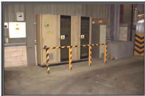
Ejemplo de protección de cuadros eléctricos contra golpes de los equipos automotores
