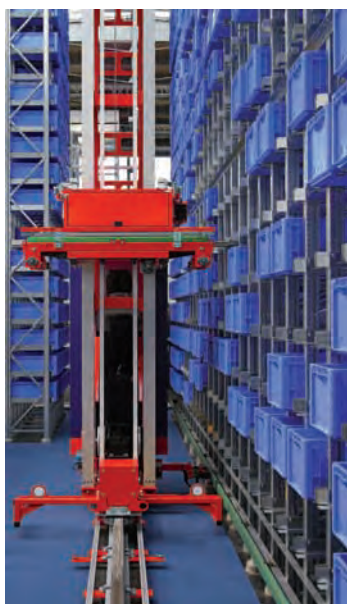
Equipo automatizado transelevador
