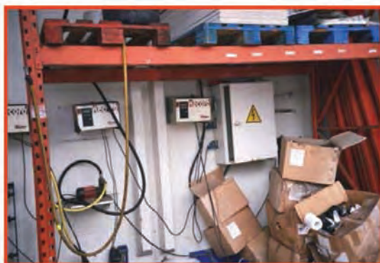
Ubicación inadecuada de los cargadores
