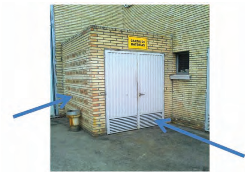
Los locales de baterías dispondrán de dos entradas de aire
