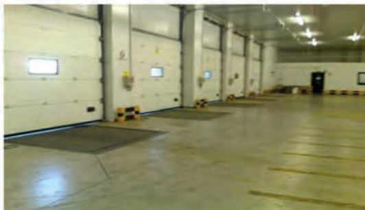
El cuadro de mando se encuentra protegido frente a posibles golpes
