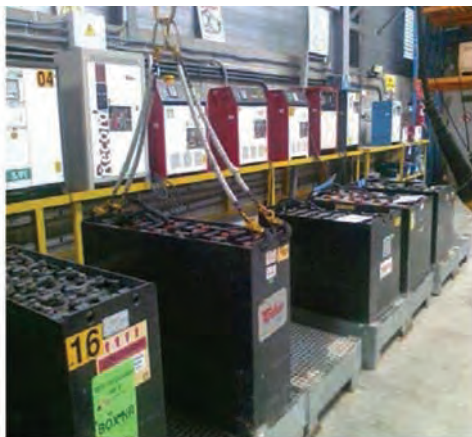
Sala de carga abierta de carretillas elevadoras
