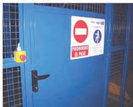
Puerta de acceso a un transelevador
