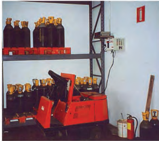
Ubicación inadecuada de los cargadores
