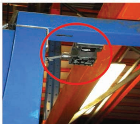
Puerta de acceso a un transelevador
