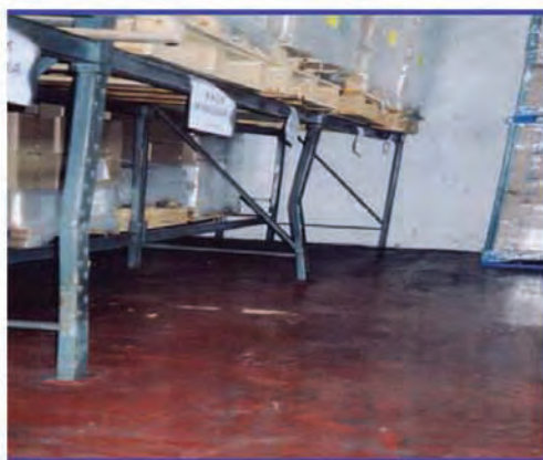
Puntales sin protección
